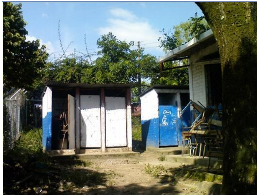
SANITARIOS A SUSTITUIR
