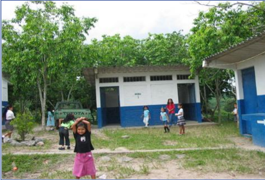
SANITARIOS COLAPSADOS A SUSTITUIR
