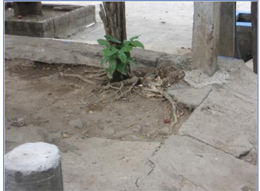
ACERAS Y CANALETAS A REPARAR
