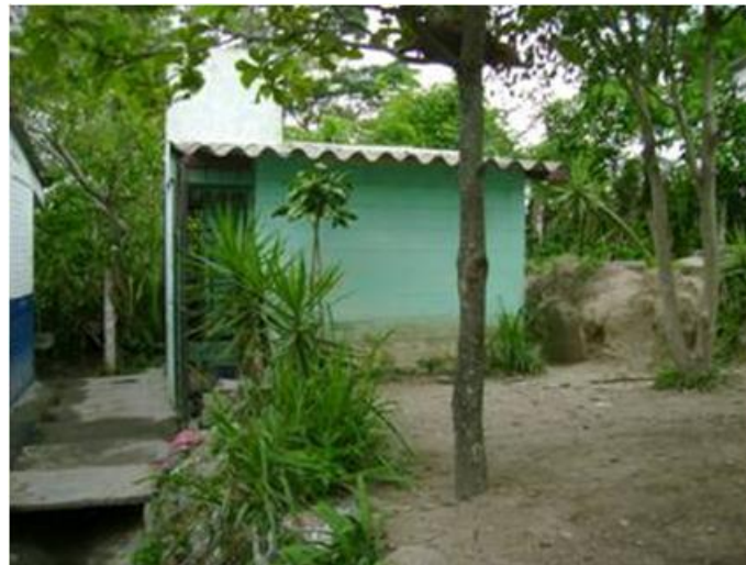
SANITARIOS A REPARAR
