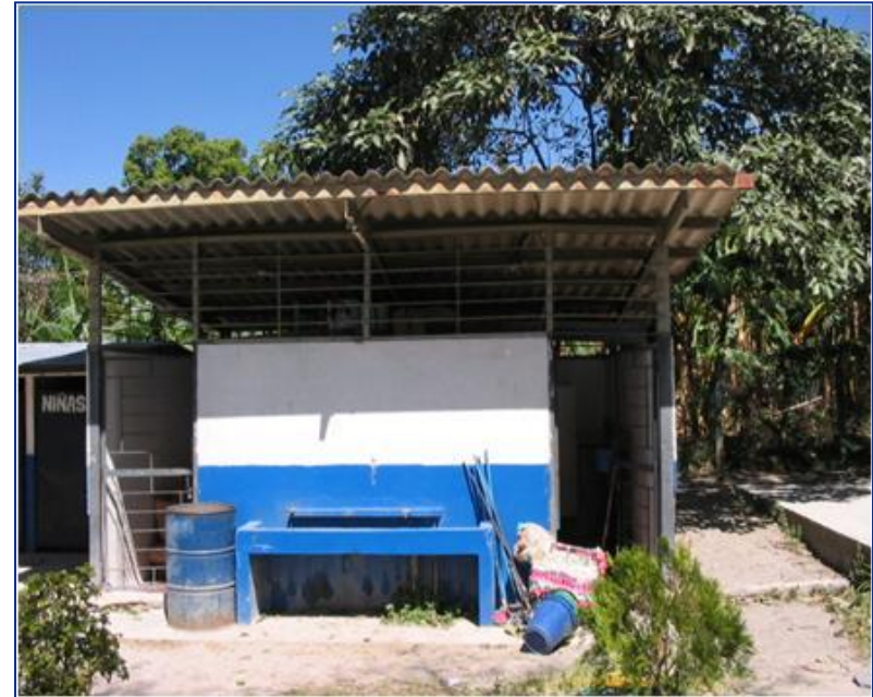
MODULO DE SERVICIOS SANITARIOS COLAPSADOS
